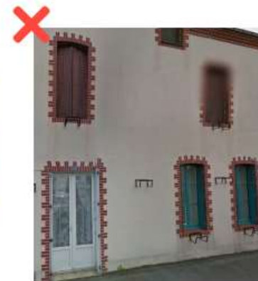
Absence d'harmonisation au niveau des ouvertures
