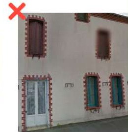
Absence d'harmonisation au niveau des ouvertures
