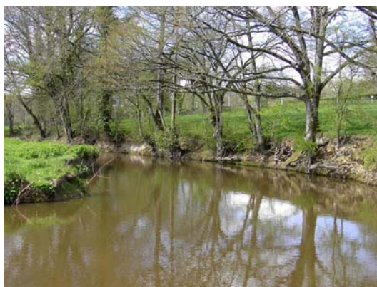
Erosion de berge dans le lit mineur de l'Erdre
