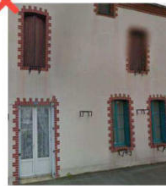
Absence d'harmonisation au niveau des ouvertures
