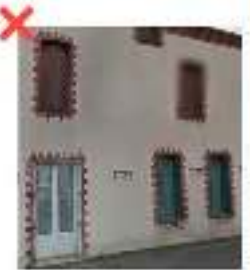
Rénovation maladroite de la façade (2018)
