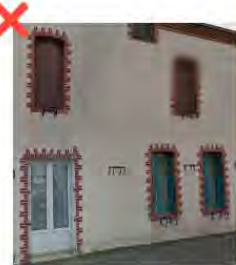
Absence d'harmonisation au niveau des ouvertures
