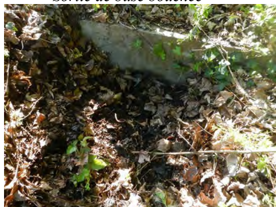
Sortie de buse bouchée
