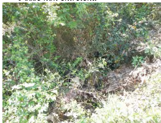
Fossé non entretenu
