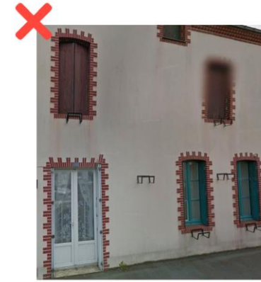
Absence d'harmonisation au niveau des ouvertures
